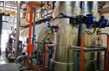
การติดตั้งระบบผลิตพลังงานร่วมเพื่อ ทดแทนระบบผลิตพลังงานแบบแยกส่วน บริษัท เพอร์เฟก คอมพานีเนีย กรุ๊ป จำกัด
