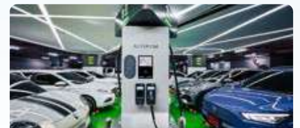
130 สถานีติดตั้งระบบชาร์จรถไฟฟ้าส่งเสริมพลังงานไฟฟ้าสะอาด
